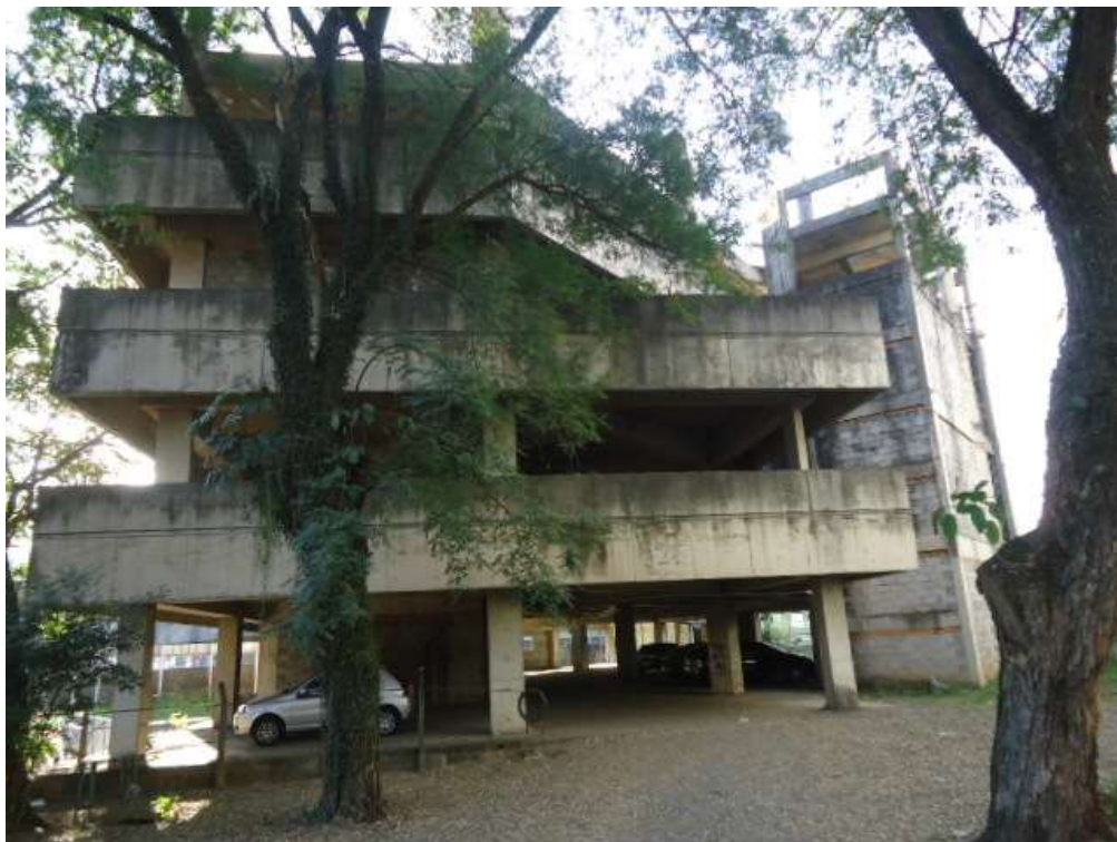
FOTO N.º 335- Aspecto da edificação onde seria instalada a sede social do clube, a qual encontra-se com as obras paralisadas.
