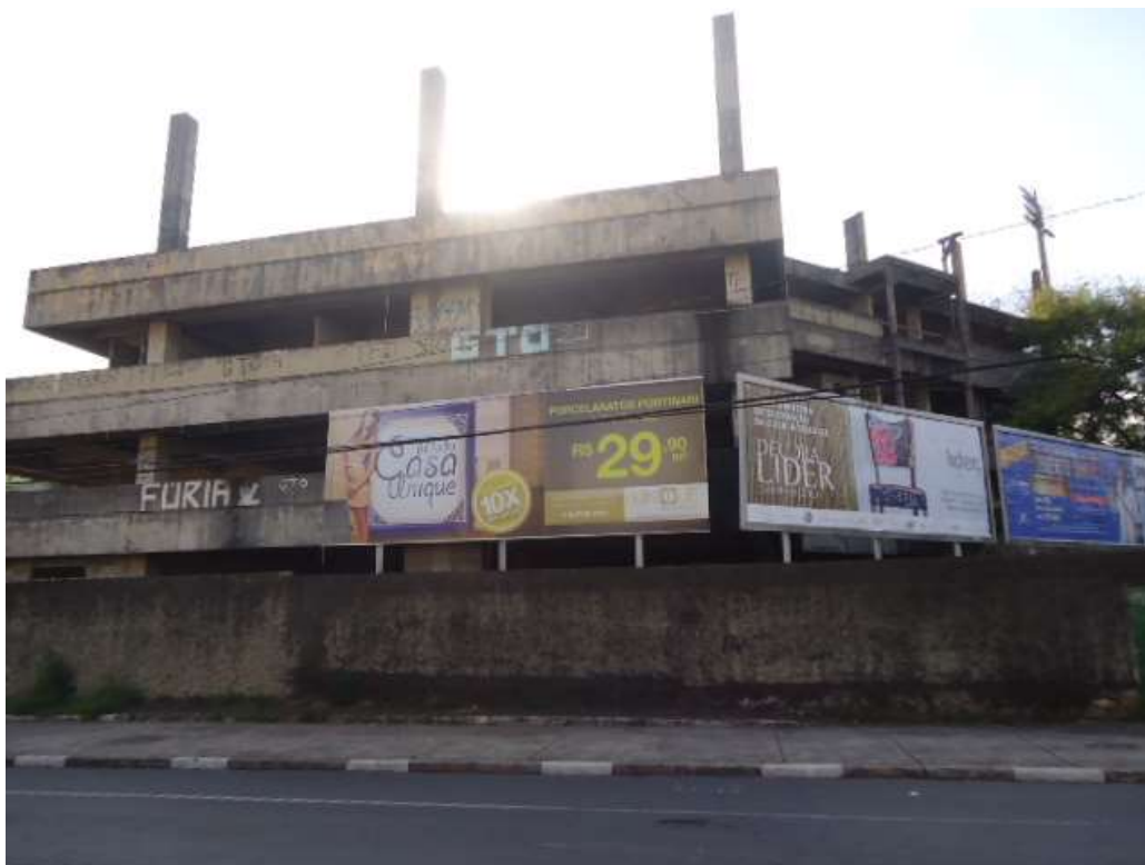
FOTO N.º 16- Vista da edificação paralisada, onde seria construída a sede social do clube.
