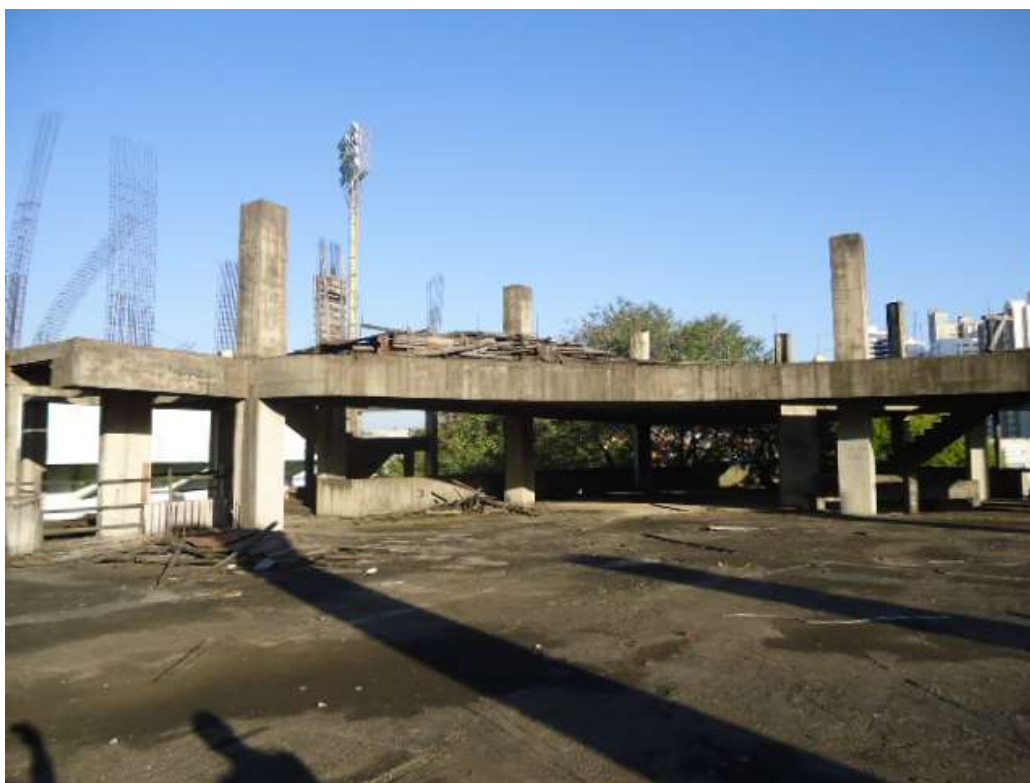
FOTO N.º 347- Tomada do 3º pavimento da edificação onde seria instalada a sede social do clube, a qual encontra-se com as obras paralisadas.
