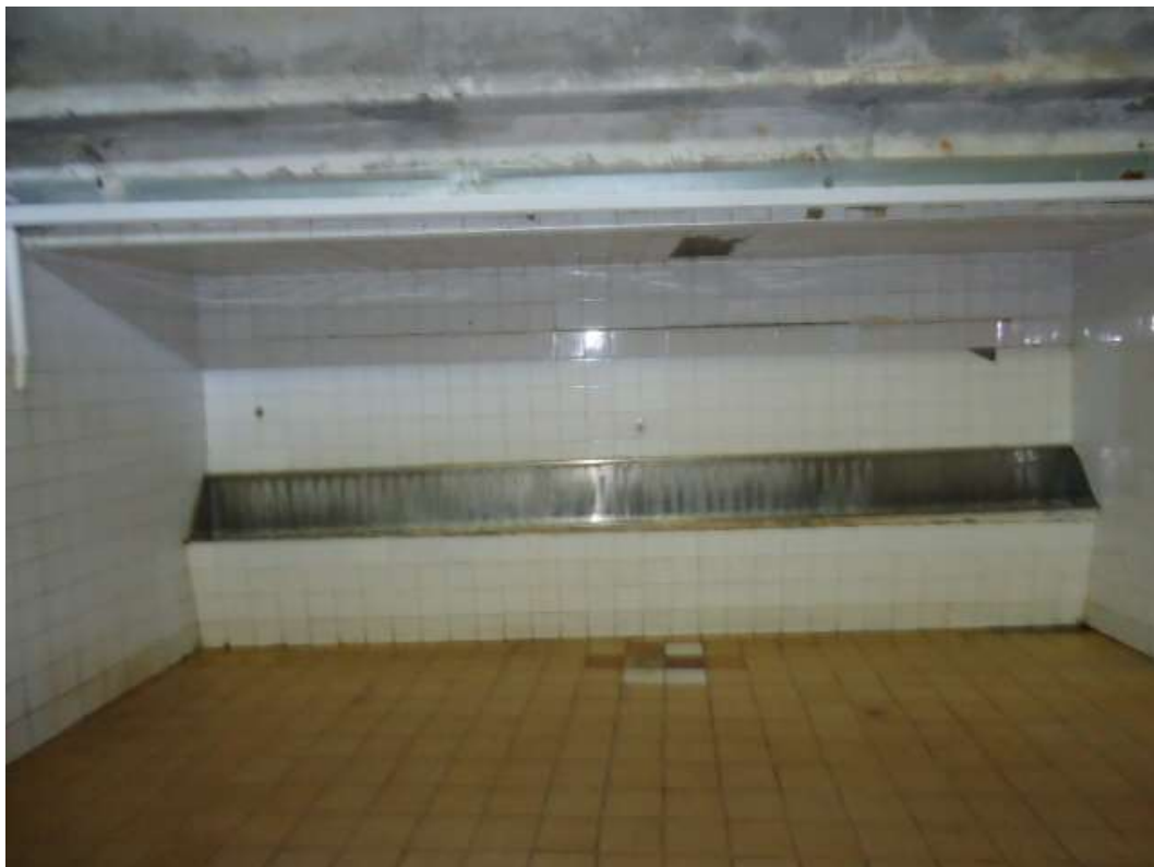
FOTO N.º 239- Tomada interna do sanitário masculino.
