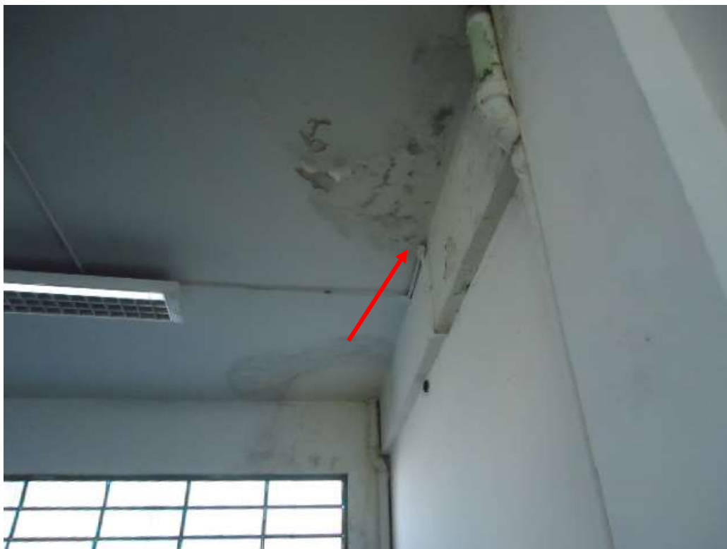
FOTO N.º 58- Detalhe de eflorescência na parede e na laje da sala de musculação, devido a infiltrações nas arquibancadas.
