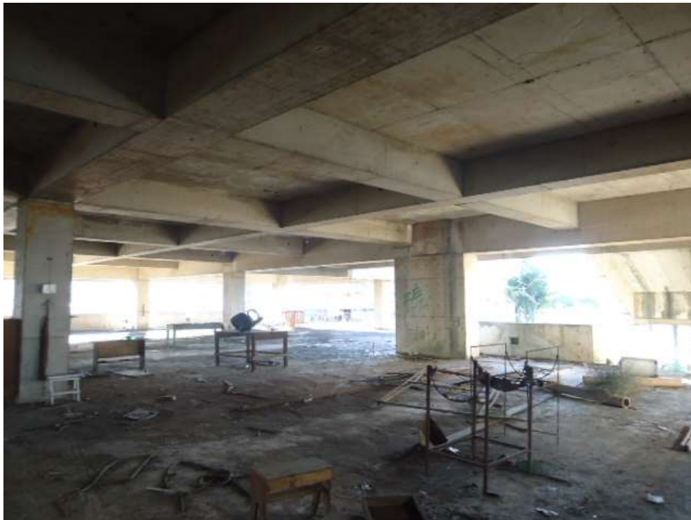
FOTO N.º 339- Vista do 1º pavimento da edificação onde seria instalada a sede social do clube, a qual encontra-se com as obras paralisadas.
