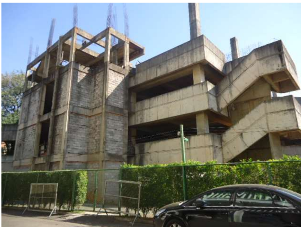
FOTO N.º 107- Vista da edificação onde seria instalada a sede social do clube, a qual encontra-se com as obras paralisadas.
