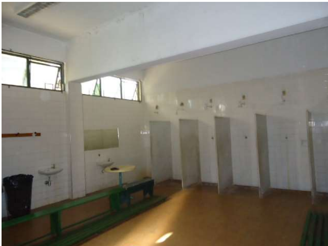
FOTO N.º 221- Tomada interna do sanitário masculino.
