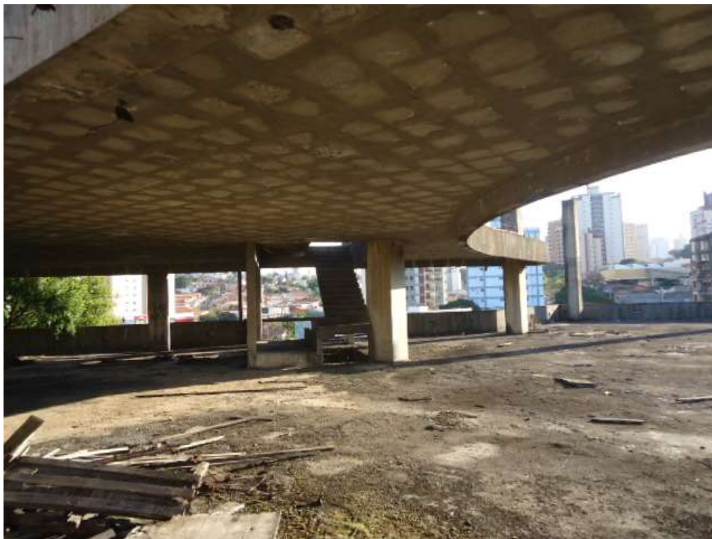
FOTO N.º 344- Tomada do 3º pavimento da edificação onde seria instalada a sede social do clube, a qual encontra-se com as obras paralisadas.
