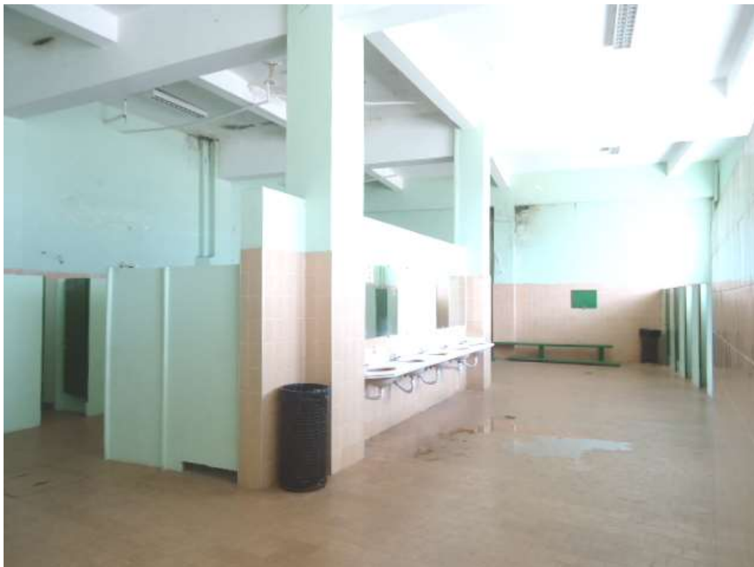
FOTO N.º 172- Tomada interna do vestiário masculino de associado.
