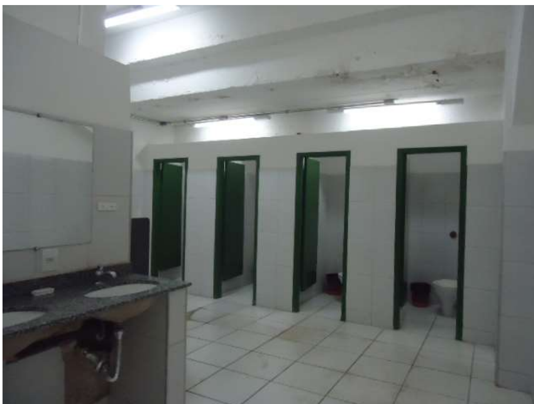
FOTO N.º 138- Tomada interna do sanitário masculino.
