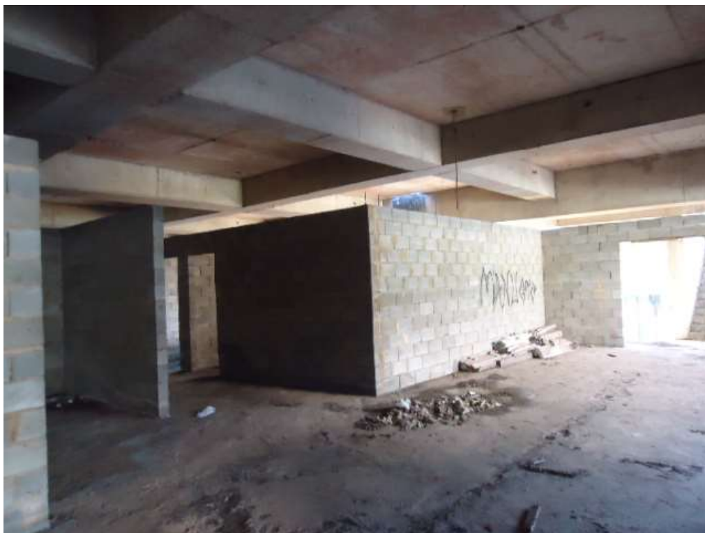
FOTO N.º 342- Tomada do 2º pavimento da edificação onde seria instalada a sede social do clube, a qual encontra-se com as obras paralisadas.
