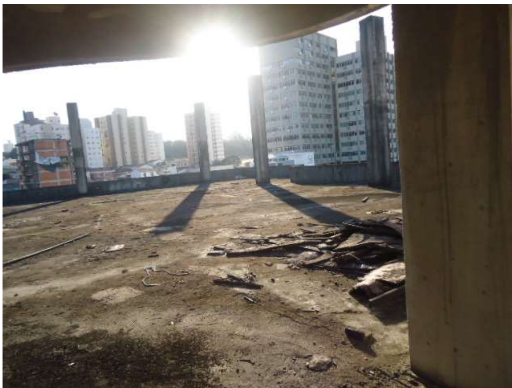
FOTO N.º 345- Vista do 3º pavimento da edificação onde seria instalada a sede social do clube, a qual encontra-se com as obras paralisadas.
