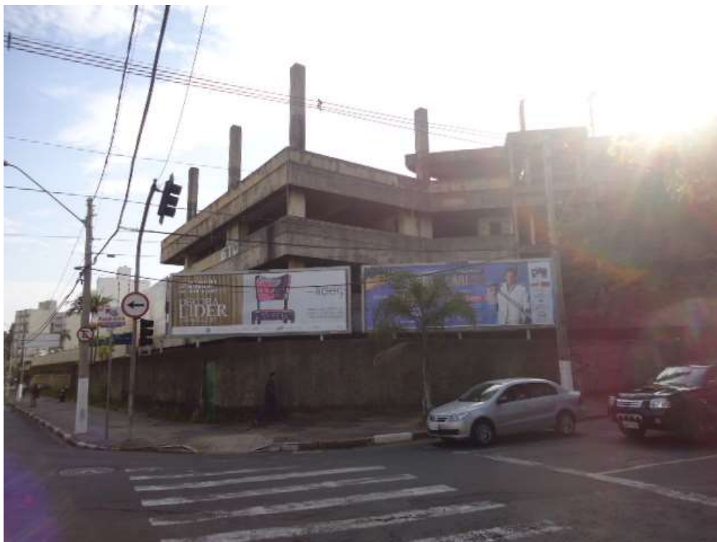
FOTO N.º 14- Tomada da estrutura de concreto da futura sede social e do estádio na esquina da Av. Princesa D'Oeste, com a Rua Conde D'Eu, onde podemos observar a edificação com obras paralisadas onde seria a sede social do clube.
