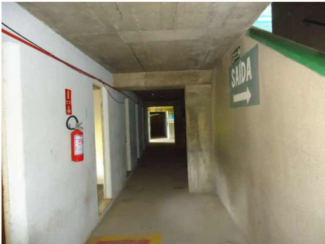
FOTO N.º 260- Tomada do corredor interno.
