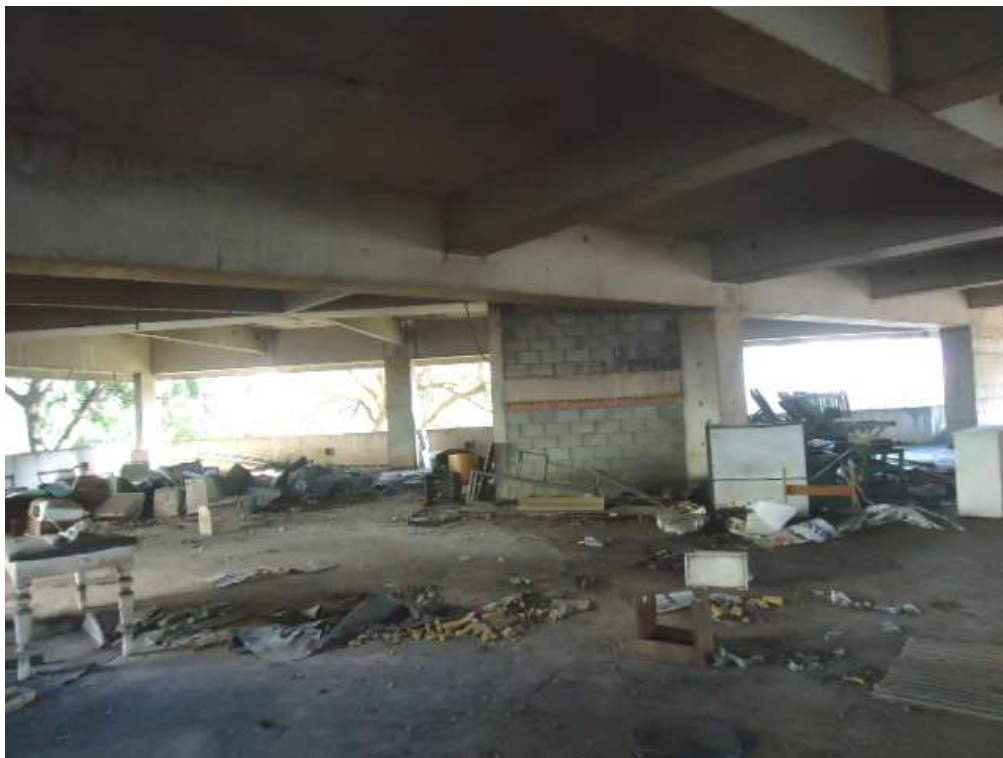
FOTO N.º 338- Tomada do 1º pavimento da edificação onde seria instalada a sede social do clube, a qual encontra-se com as obras paralisadas.
