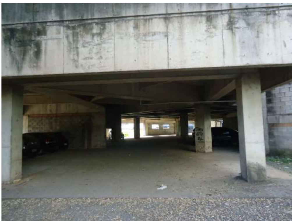
FOTO N.º 336- Vista do pavimento térreo da edificação onde seria instalada a sede social do clube, a qual encontra-se com as obras paralisadas.
