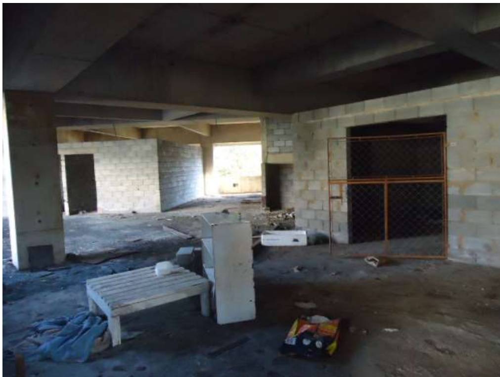
FOTO N.º 341- Aspecto do 2º pavimento da edificação onde seria instalada a sede social do clube, a qual encontra-se com as obras paralisadas.
